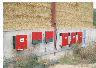
Wechselrichter auf der Ostseite; morgens Sonne plus Wärmestau durch Stroh
