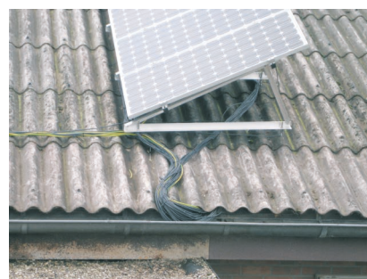
Gefährdung durch nicht korrekte Verlegung der Gleichstromleitungen
